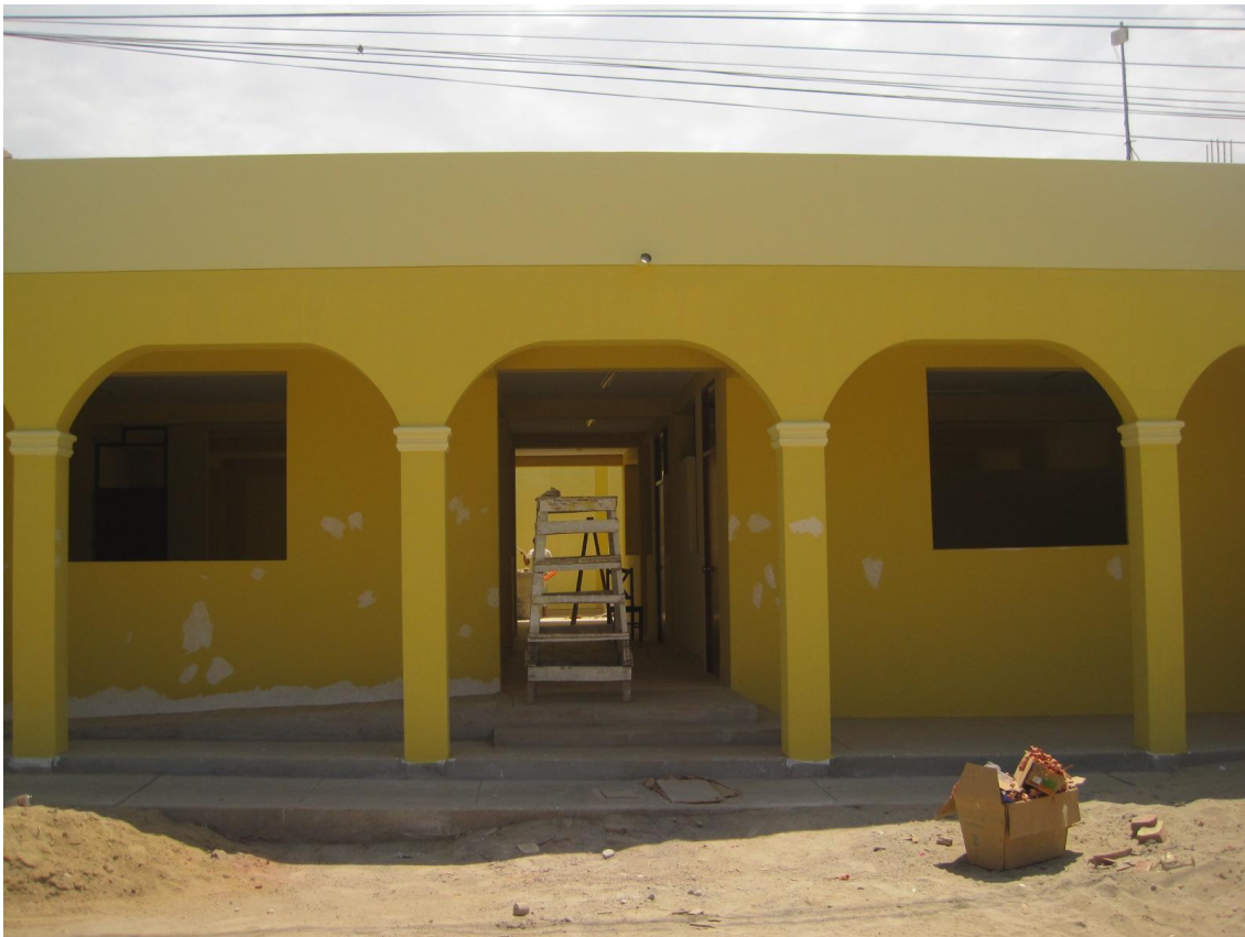
FOTO N°09- SE APRECIA LA VEREDA EXTERIOR TOTALMENTE CONCLUIDA CON SU CAJA DE AGUA Y DESAGÜE Y SU RAMPA PARA DISCAPACITADOS
