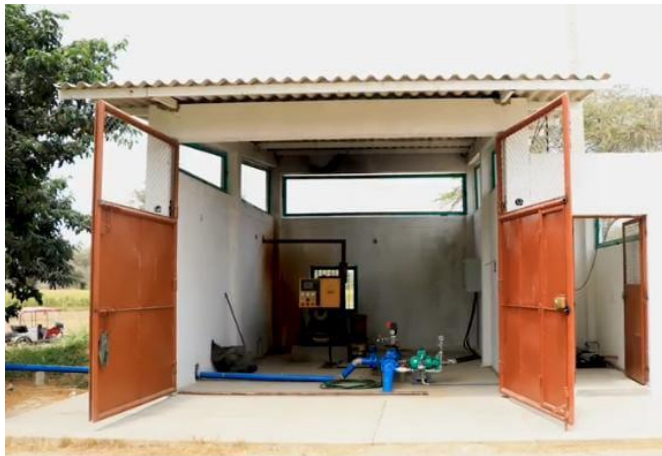
CASETA DE BOMBEO JASS STA. ELENA Y SR. DE LOS MILAGROS-STA ELENA
